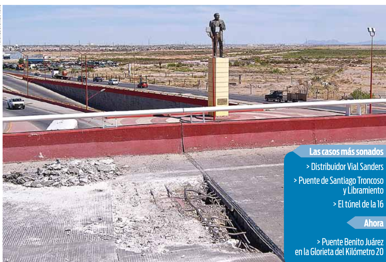
El hundimiento en el carril ocasiona movimientos en el puente.
